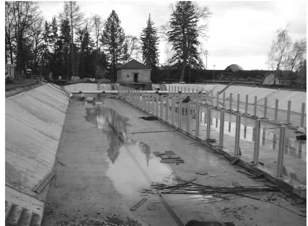
Obr. 6. ÚV Plzeň – nová nádrž předsedimentace
